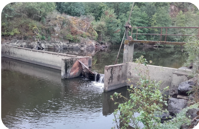
Vue aval du barrage et du clapet détérioré (27/08/2018)
